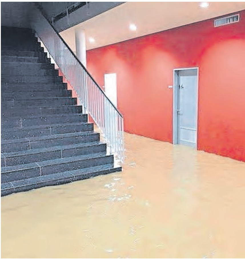
Das Untergeschoss des Zentrums Teufmatt stand nach dem Unwetter vom 7. Juni 2015 vollkommen unter Wasser.
