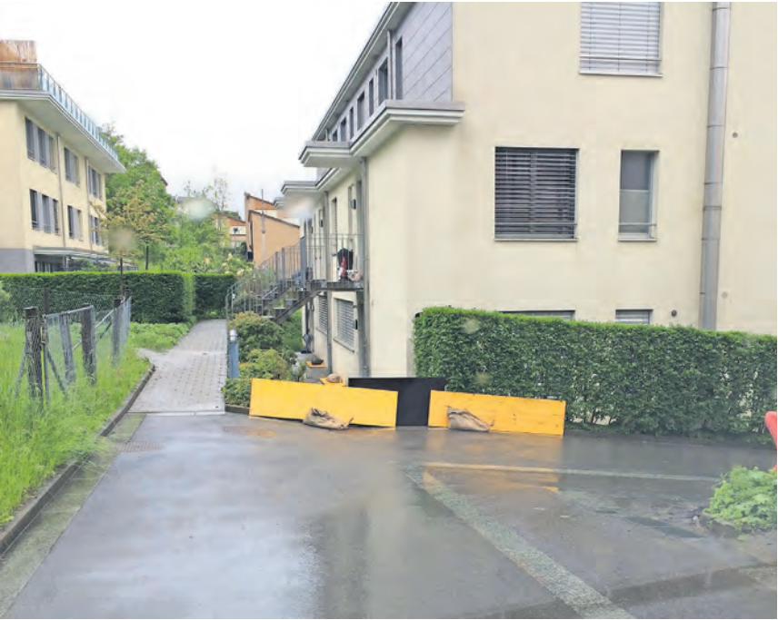
Private Objektschutzmassnahme – hier am Zentrumsweg.
