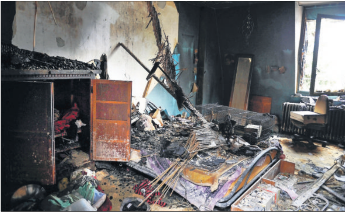
Der Brand vom letzten Samstag hat verheerende Spuren hinterlassen: links eines der Kinderzimmer, rechts der zerstörte Boiler in der Küche.
